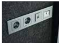
Anschlüsse in der Kabine
